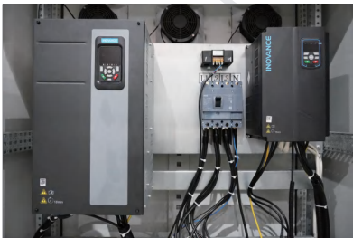
电气系统 Electrical System
